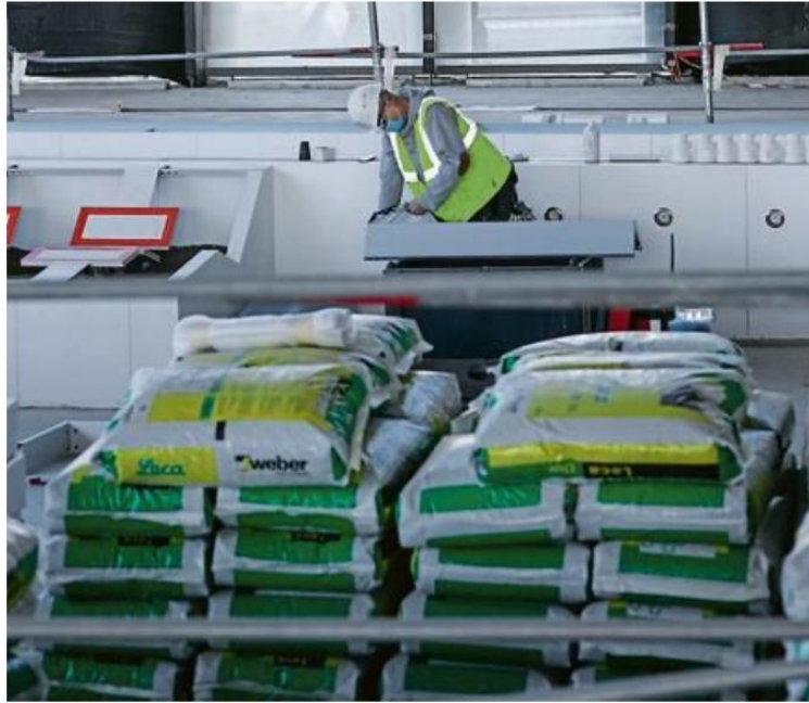
Nombre de chantiers du bâtiment ont repris avec le déconfinement, comme ici à Rueil-Malmaison.
